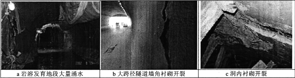
图 1.1 隧道水害与开裂
