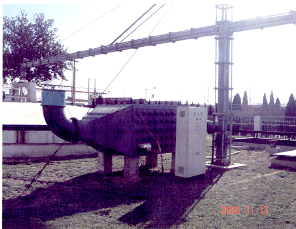
图 7.1 光化学除臭设备近景
